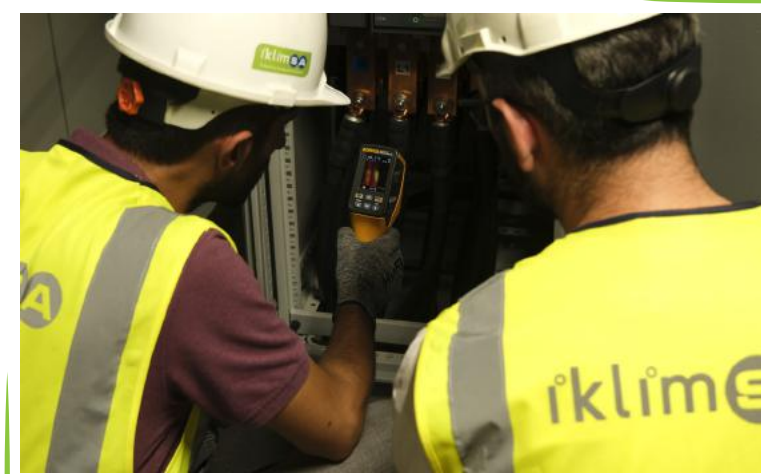
Termal Kamera ile Bağlantı Kontrolleri
